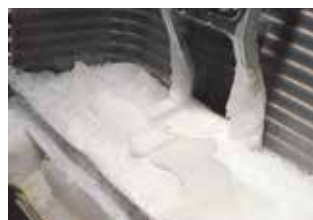
Zalodzenie tacy ociekowej bez grzałki elektrycznej
